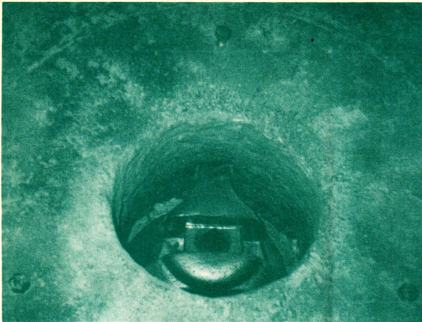
De drie koppen van de stelbouten, die de loper precies doen afstellen, zijn hier goed te zien.
