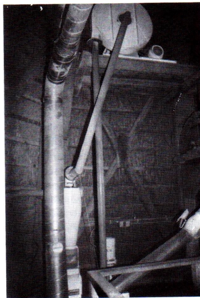
Foto 1: Rechtsboven op de foto is de waaier te zien die de onderdruk levert voor de kleine cycloon, half verscholen achter een leiding van het pneumatisch transport. Links van de cycloon zit de pijp die het meel aanzuigt.
